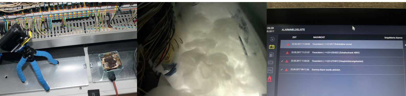
Abb. 3: Rauchversuch (links: Actionkamera auf Stativ und Rauchquelle; Mitte: Rauchentwicklung in geschlossenem Schaltschrank; rechts: Alarmmeldeliste Fahrstand)
